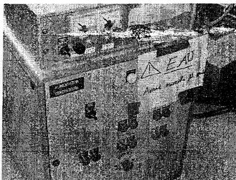
Figure 51 : coffret d'alimentation et de commande
