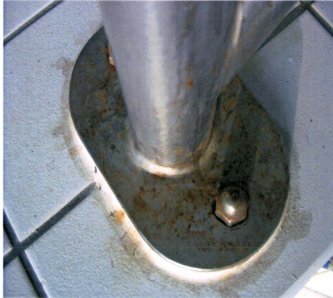
Figure 1.7 : Corrosion par piqûres [CAL08]
