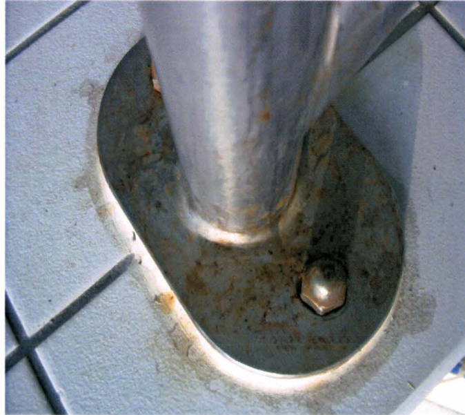
Figure 1.7 : Corrosion par piqûres [CAL08]
