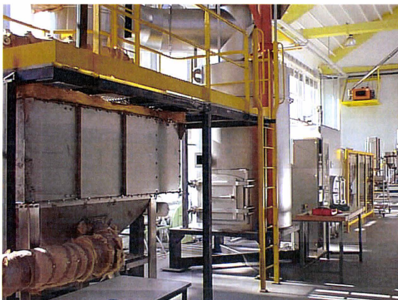
Figure 1-2 : Photo de la chambre de décendrage, de la postcombustion, de la chaudière et du filtre à manches de la droite à gauche, respectivement
